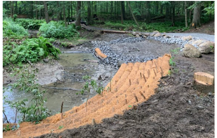
Travaux de restauration des berges à l'aire de conservation J. Henry Tweed
